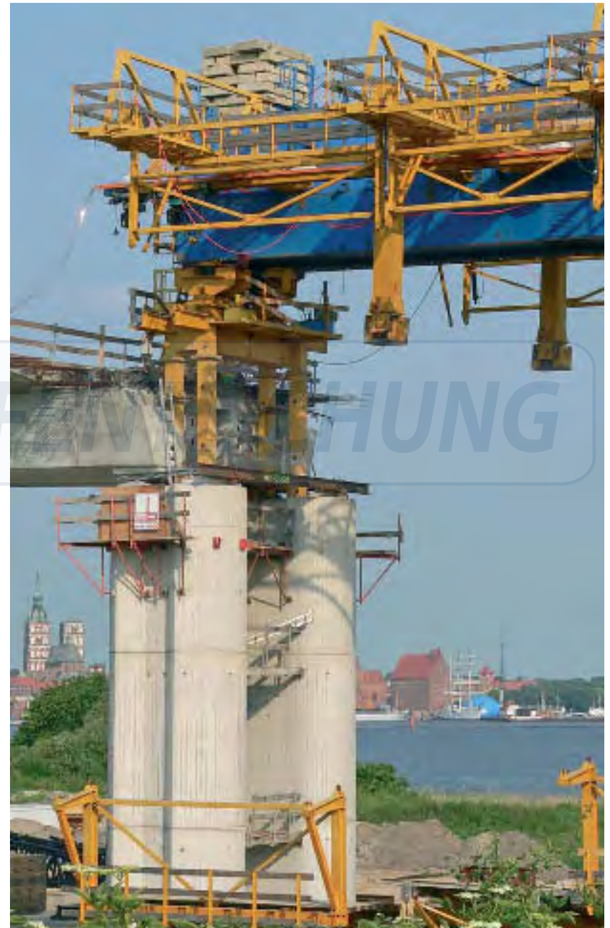
Die hintere Lagerung des Vorschubgerütes.
